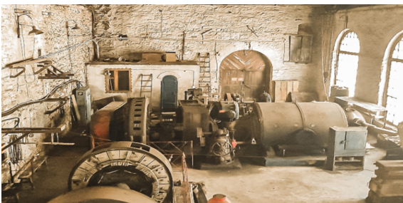
Рис. 6. Фрагмент интерьера машинного зала ГЭС «Пороги»
